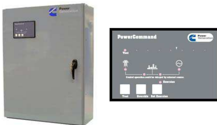
Рисунок 29 – Шкаф GTEC и панель индикации
