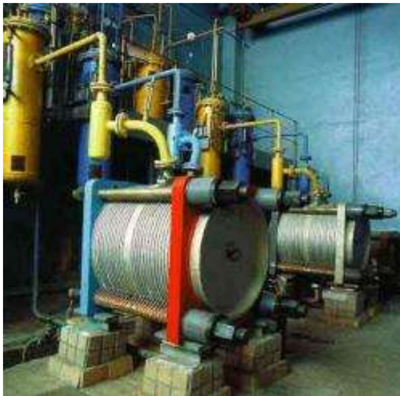
Рисунок 1 - Общий вид электролизной установки СЭУ –10–2
