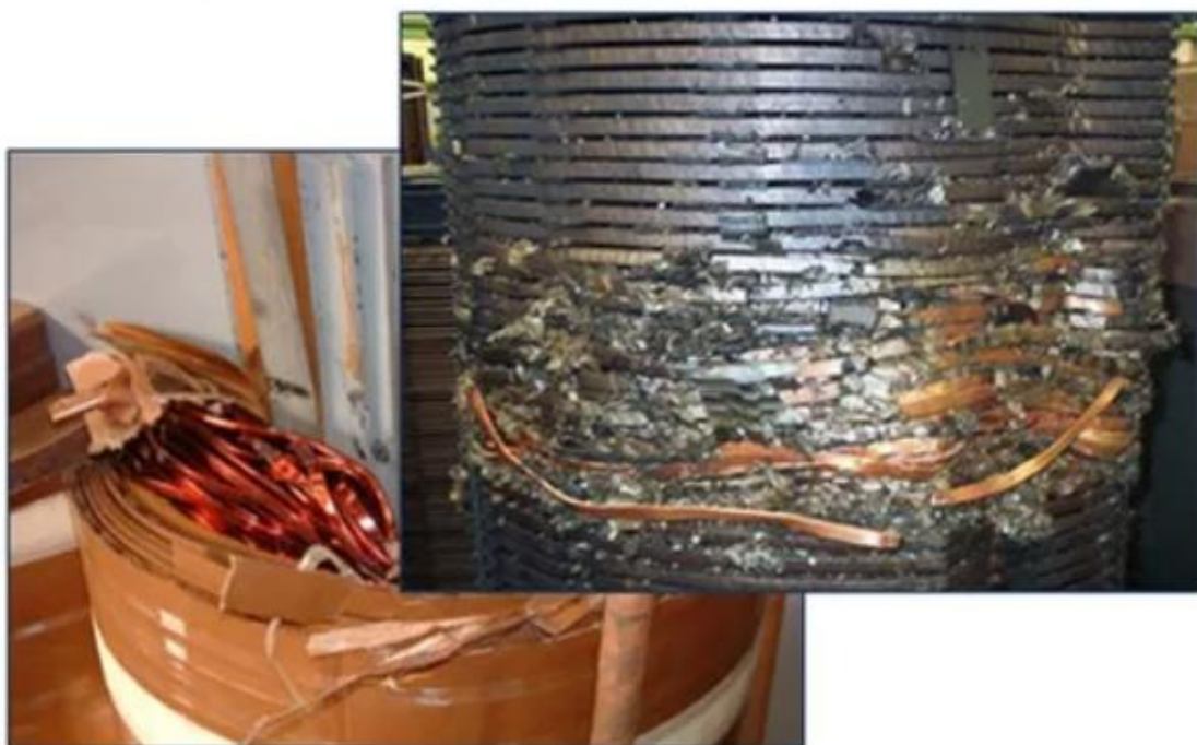
Рисунок 38 – Повреждение изоляции обмотки масляного трансформатора
