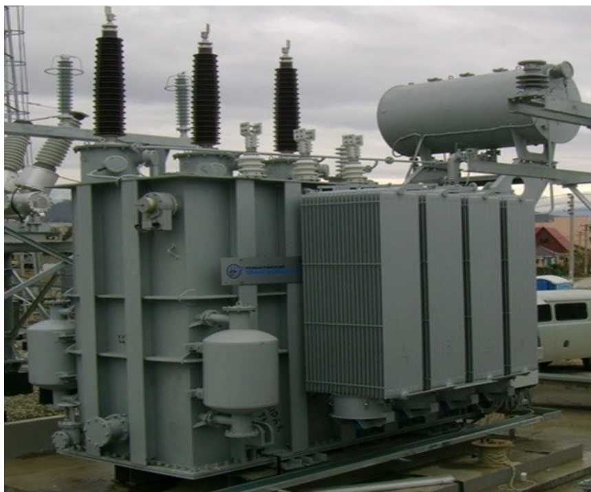
Рисунок 11 – Силовой трансформатор ТДТНШ-16000/110/6,3/6,6
