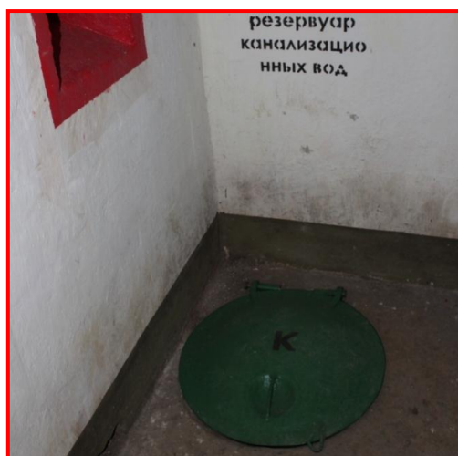
Рисунок 19 - Люк в резервуар канализационных вод
