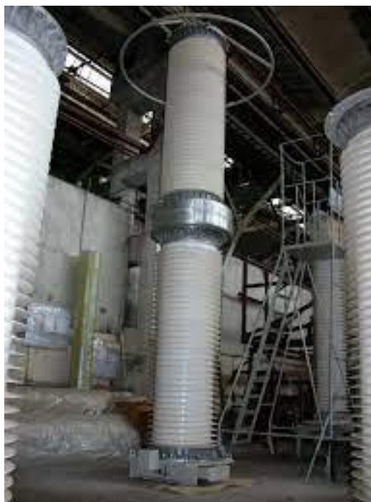
Рисунок 10 – общий вид трансформатора тока ТВГ-220
