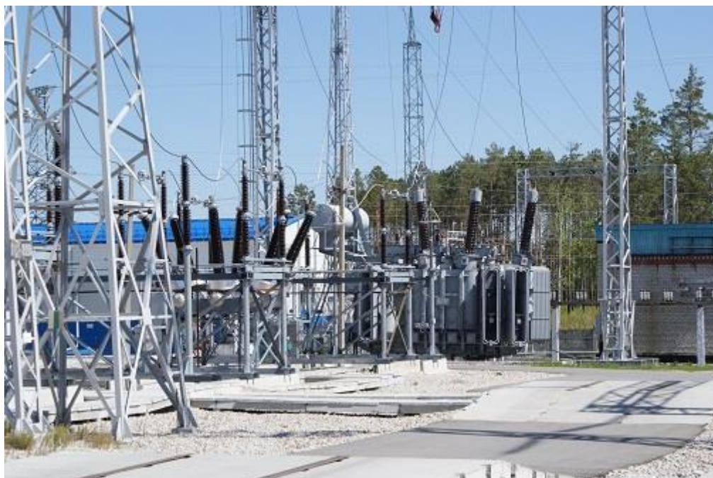
Рисунок 1 – Подстанция «Ледяная» 220/35/6 кВ
