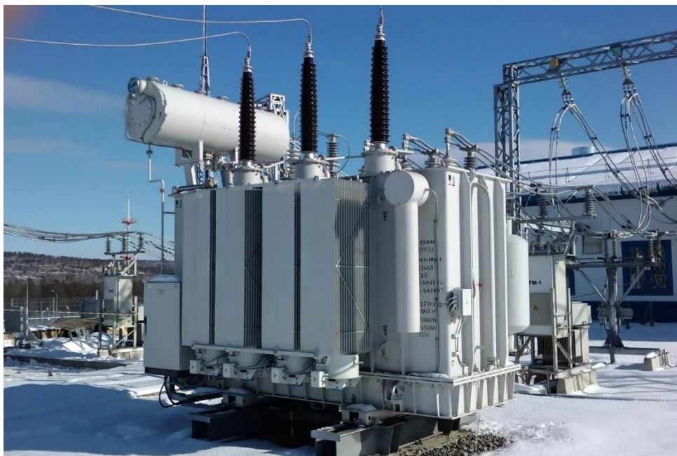
Рисунок 2 – Силовой трансформатор ТДТН-10000/110 УХЛ1
