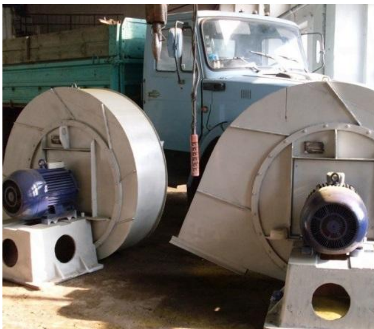
Рисунок 3 - Вентилятор дутьевой центробежный котельный - дымосос центробежный котельный ДН-9м-1500 – рисунок 4.
