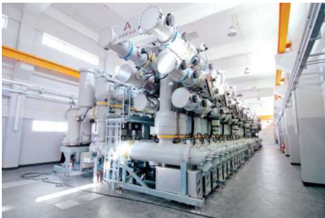
Рис. 8-5. Смонтированное КРУЭ 220 кВ компании «АЛЬСТОМ Грид –Русал Электротехиниинг» [8-4].
