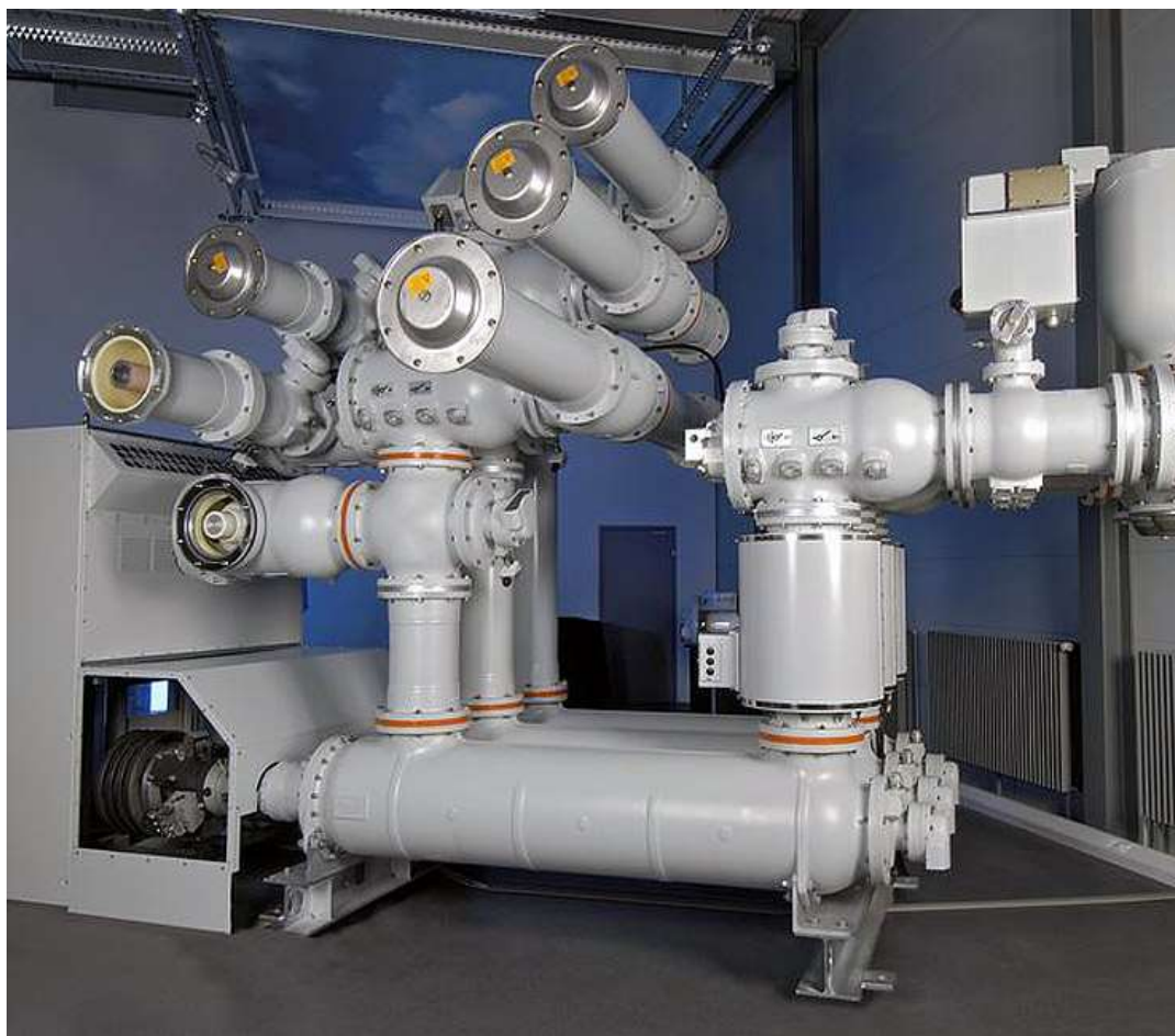
Рис. 8-4. Внешний вид секции КРУЭ 245 кВ компании ABB [8-3].
