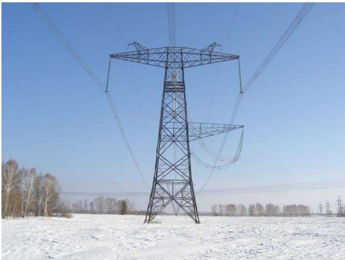
Рис. 7-1. Промежуточная опора ВЛ 1150 кВ.
