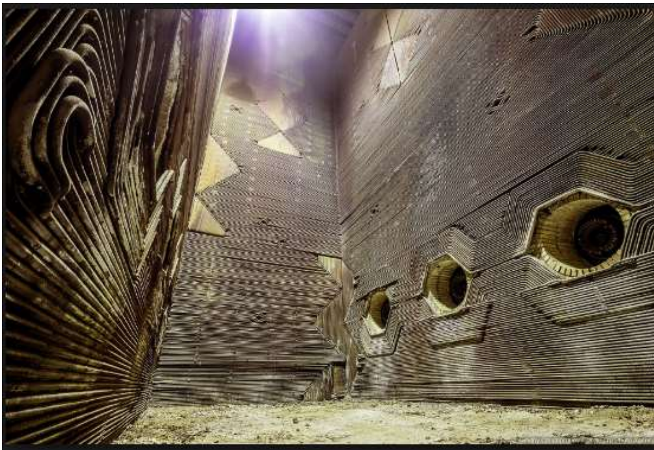
Рис. 3-6. Топочная камера газомазутного котла. Топливо подается через форсунки, футеровка которых выполнена огнеупорным (шамотным) кирпичем.
