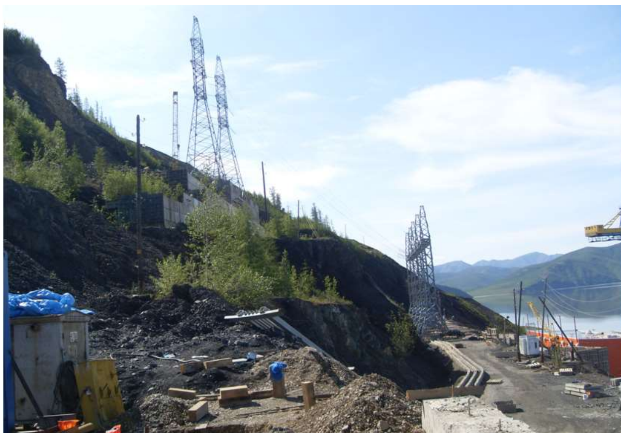
Рис. 6-4. От КРУЭ (красное здание справа внизу) ВЛ-220 кВ поднимаются вверх по крутому правому берегу Колымы. На фотографии видно, что для открытого распределительного устройства места немного.
