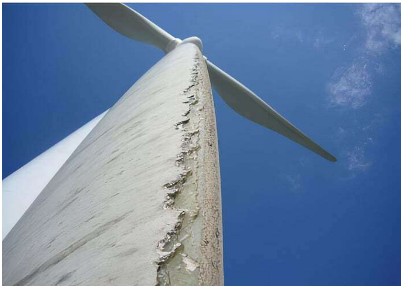
Рис. 1-6. Эрозионные повреждения передней кромки лопастей [1-6].
