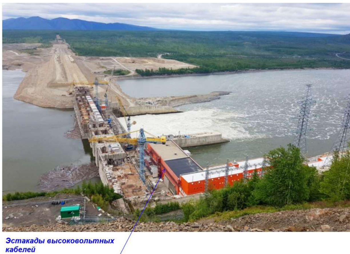
Рис. 6-2. На стене здания ГЭС смонтированы эстакады для кабелей 220 кВ.
