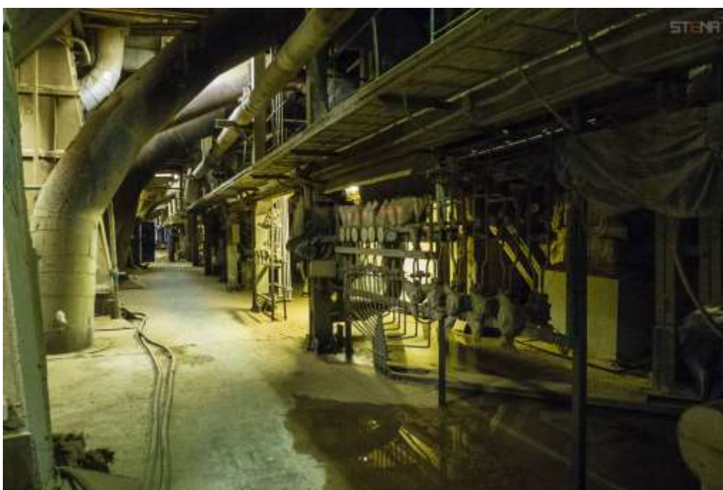
Рис. 3-3. Котельный цех Нарвской ТЭЦ.
