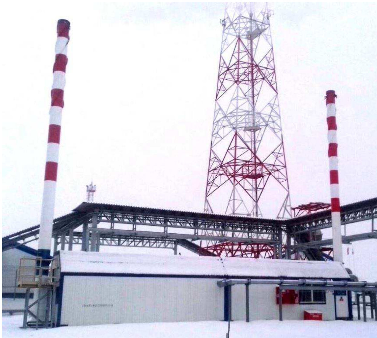
Рисунок 2 – Блочно-модульная водогрейная котельная МВК-30ГД
