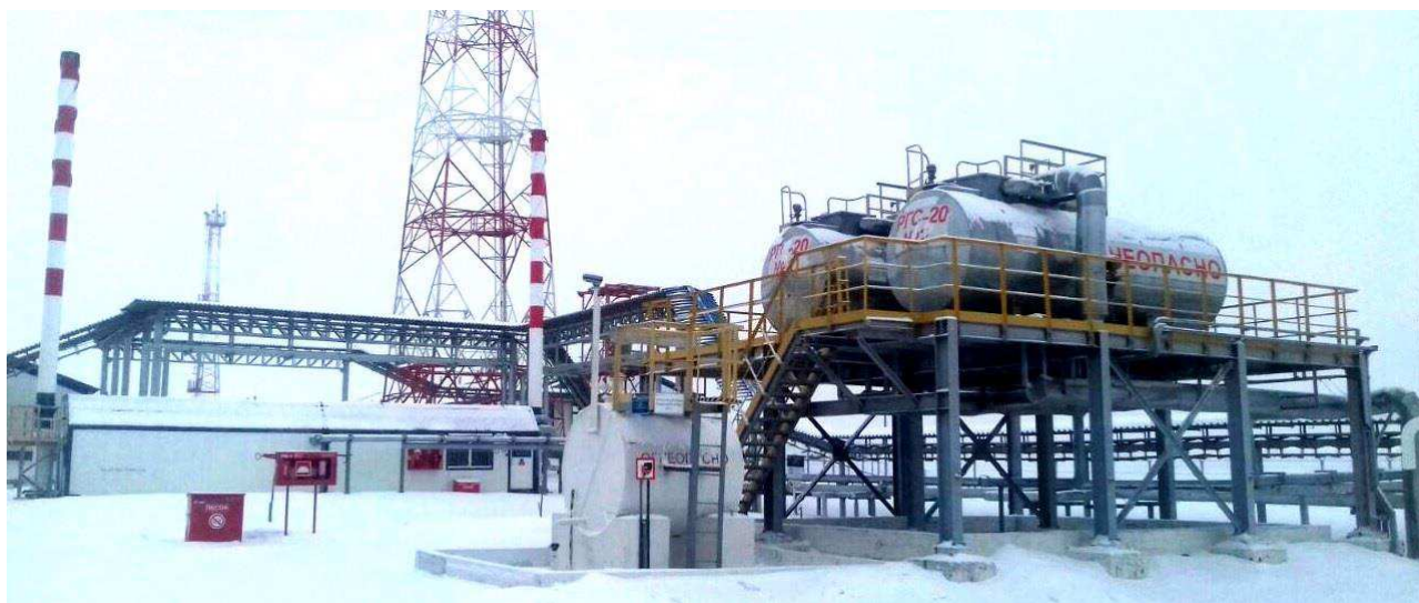
Рисунок 1 – Котельная МВК-30ГД с резервуарами РГС-20
