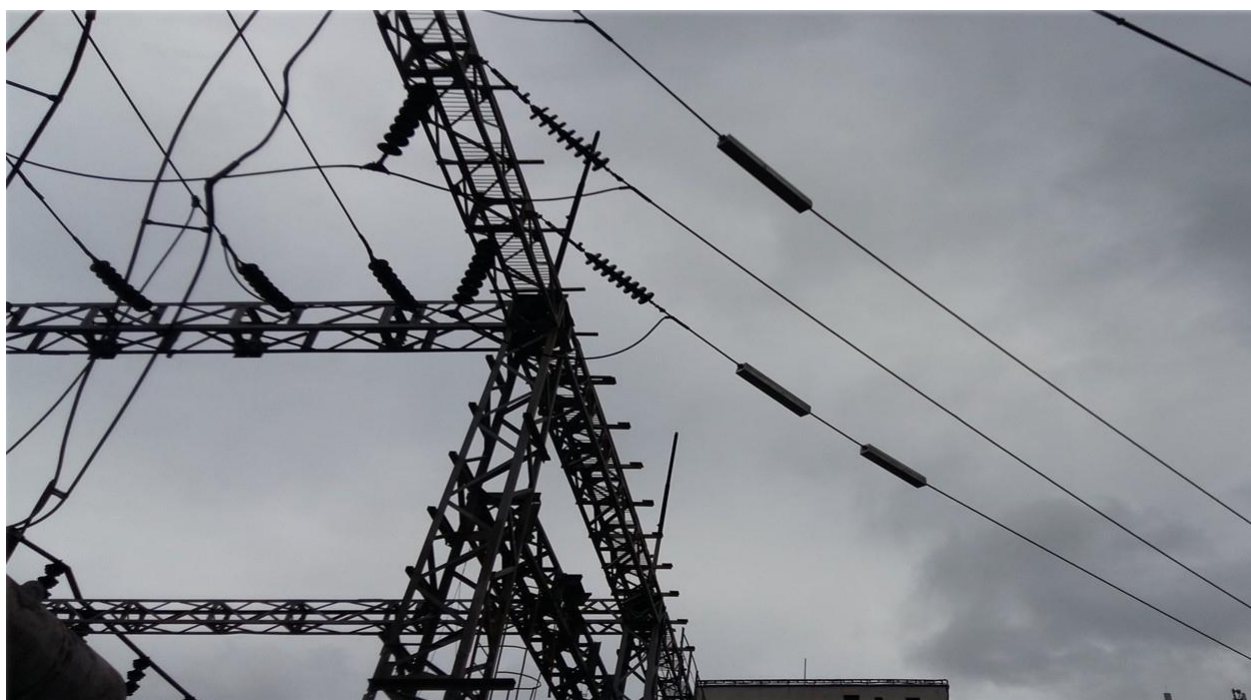
Рисунок 30 – Фото размещения МУПК на проводах ВЛ.
