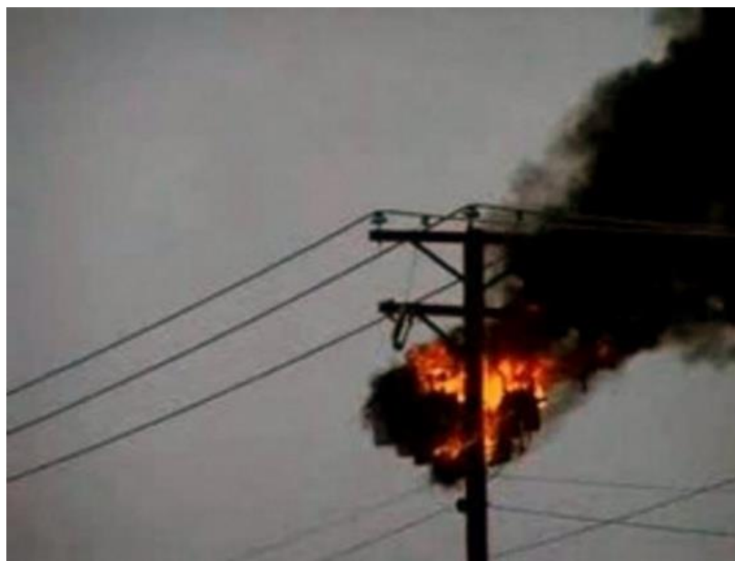
Рисунок 20 – Пожар на ЛЭП
