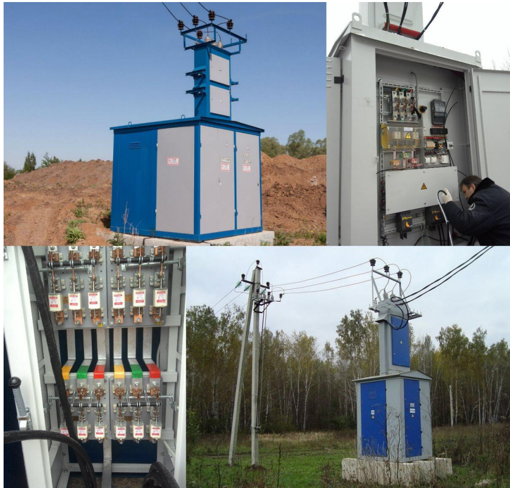
Рисунок 6 – Внешний вид комплектной трансформаторной ПС
