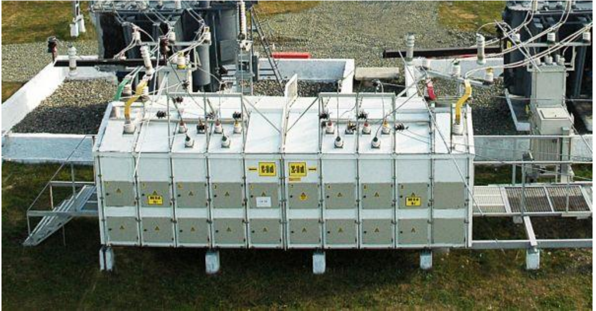
Рисунок 9 – Шкафы КРУН 10 кВ типа К-59
