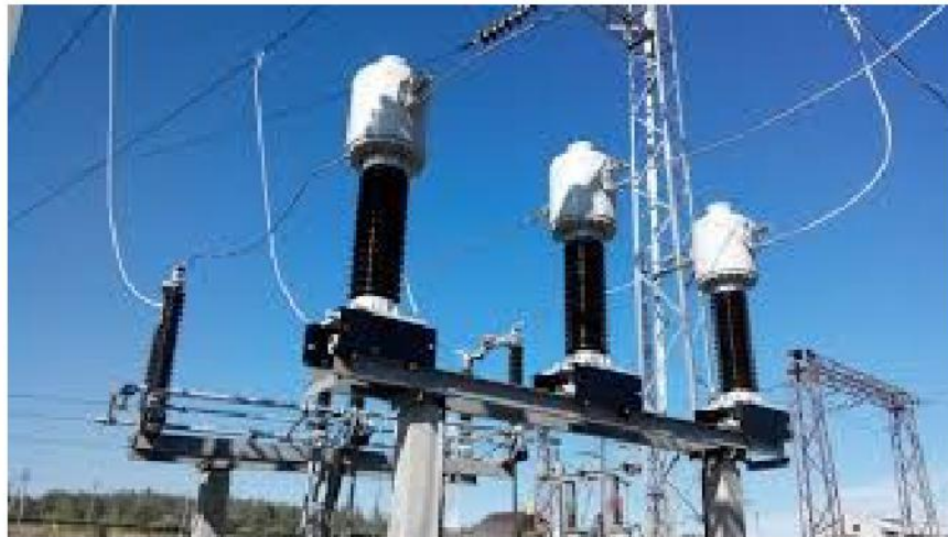
Рисунок 13 – Трансформатор тока ТГФ - 110 кВ
