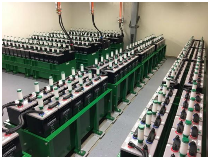
Рисунок 13 – Аккумуляторные батареи Норреске 8 OSP.НС 280
