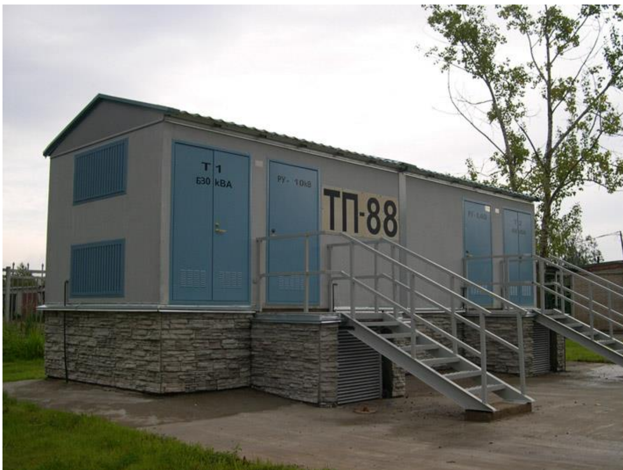
Рисунок 3 – ТП-88 с трансформаторами ТМ-630/10/0,4 кВ
