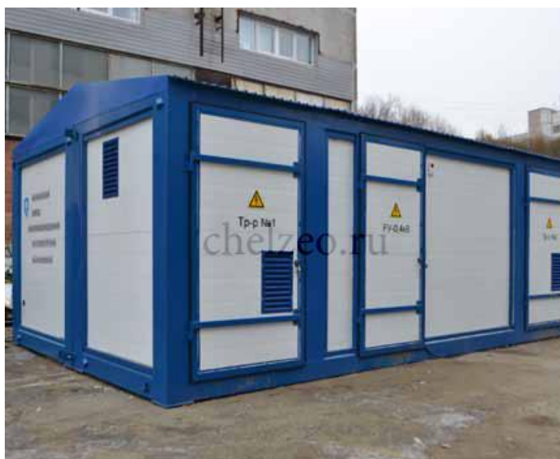
Рисунок 3 – Внешний вид комплектной трансформаторной подстанции
