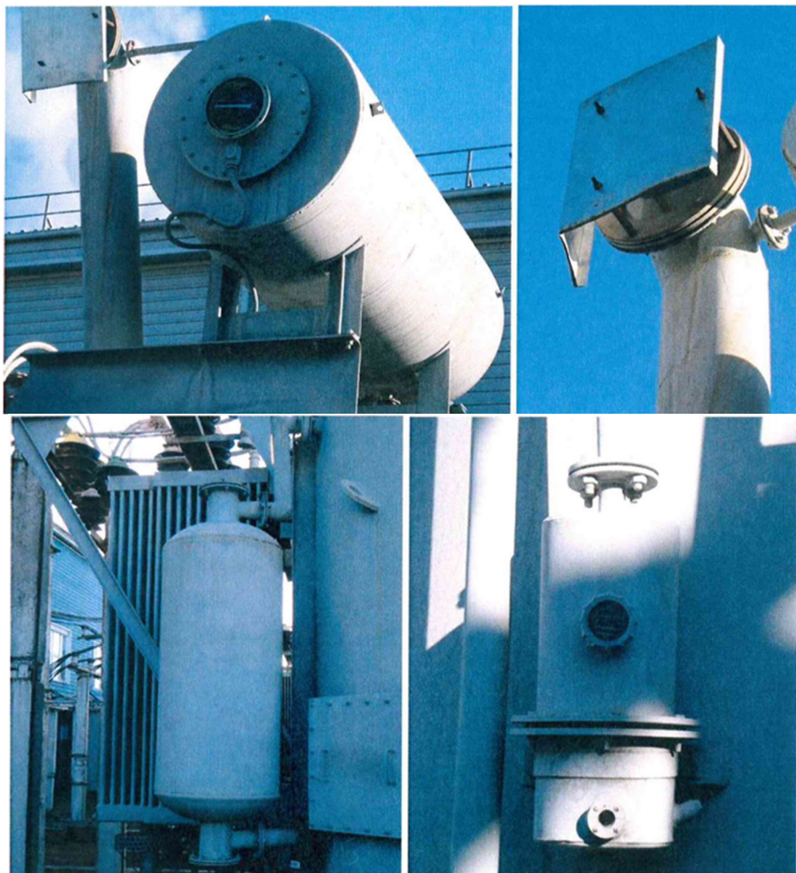
Рисунок 21 — Состояние расширителя, выхлопной трубы и термосифонного фильтра
