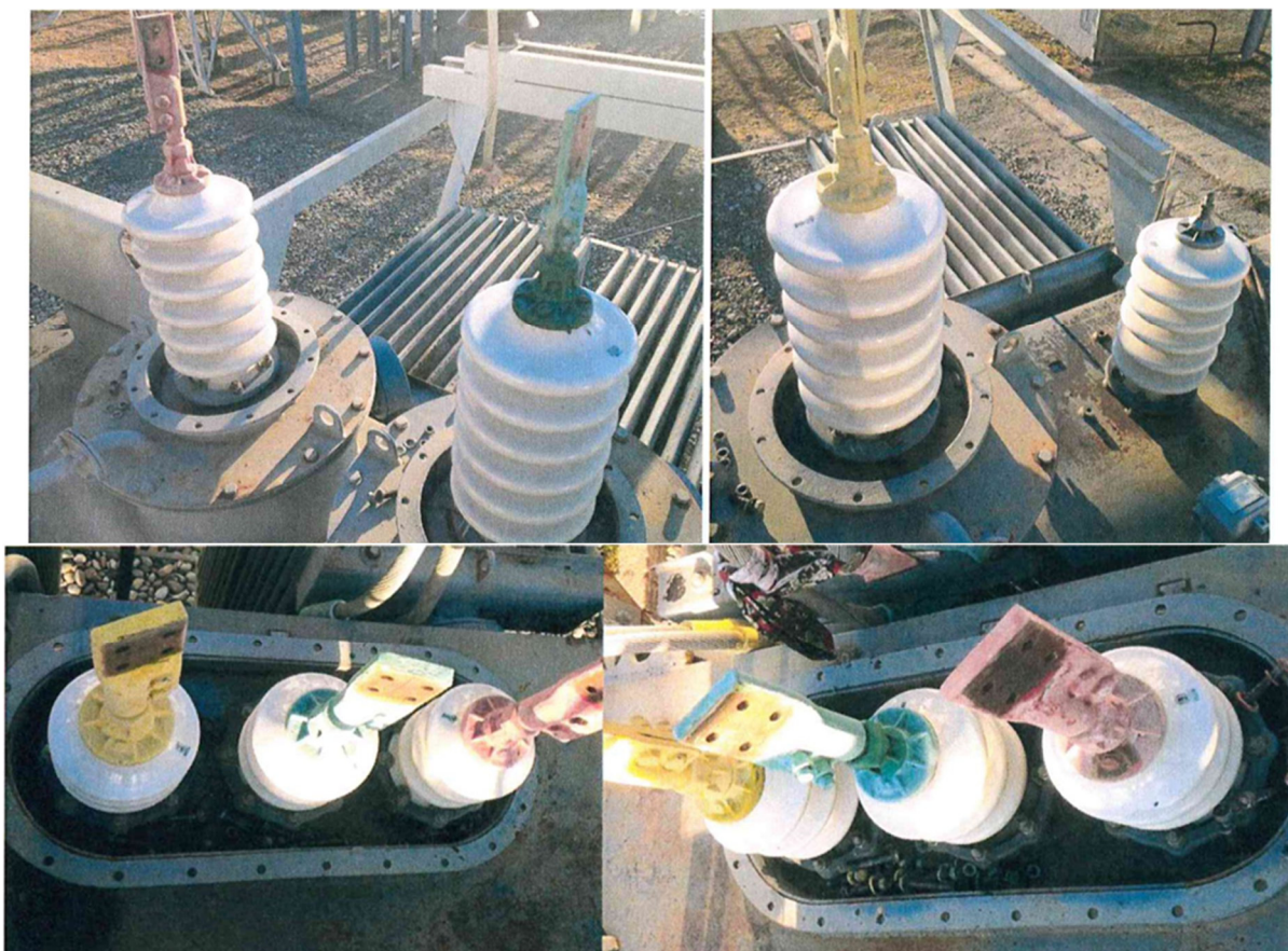
Рисунок 20 — Состояние вводов 35 кВ фаз
