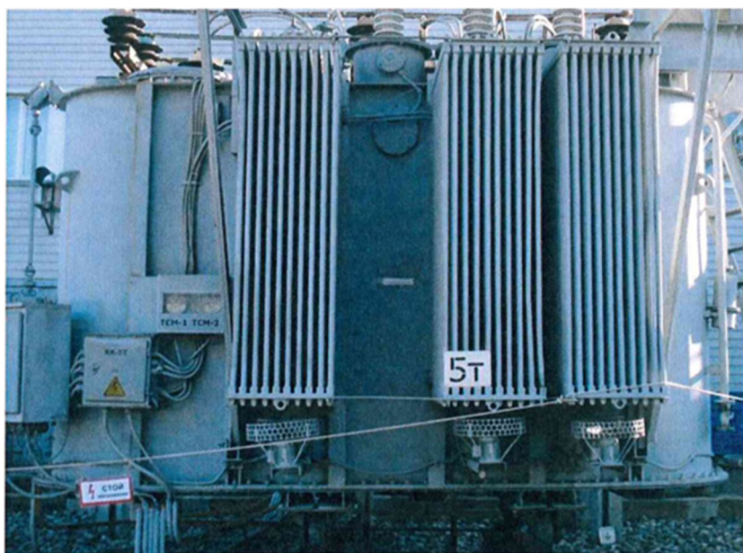
Рисунок 14 — Состояние лакокрасочного покрытия
