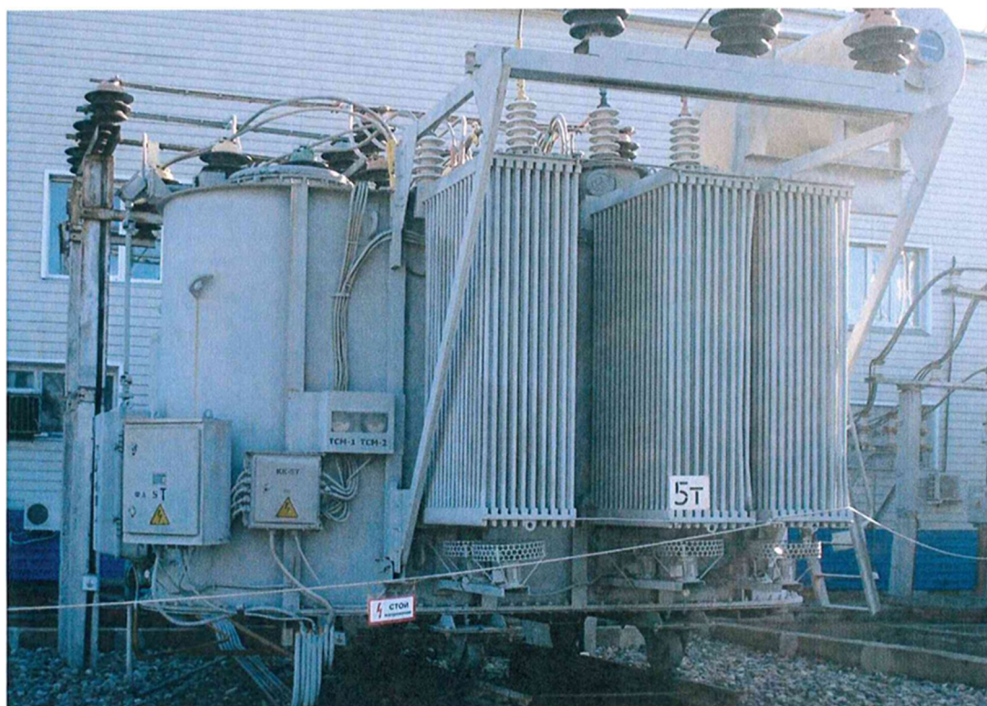
Рисунок 13 – Общий вид трансформатора 5Т
