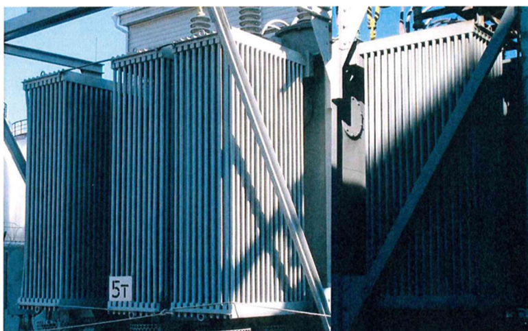
Рисунок 17 – Состояние лакокрасочного покрытия радиаторов
