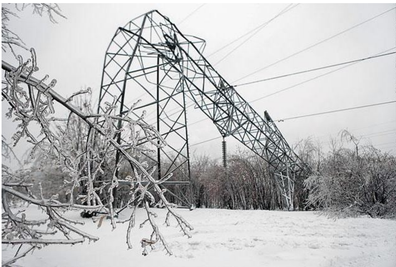
Рис. 49. Опора ЛЭП не выдержала возросшую из-за ледяного дождя механическую нагрузку [66].
