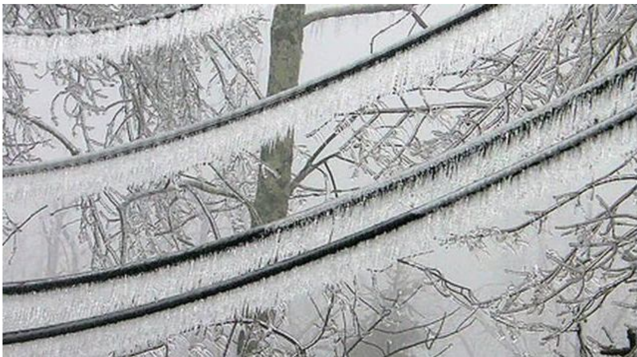
Рис. 48. Последствия ледяного дождя – на проводах ЛЭП [65].
