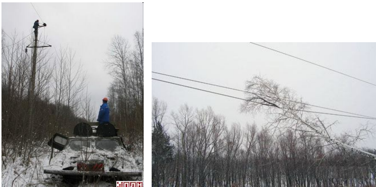
Рис. 46. Последствия несвоевременной расчистки трассы ЛЭП от зарослей [63].
