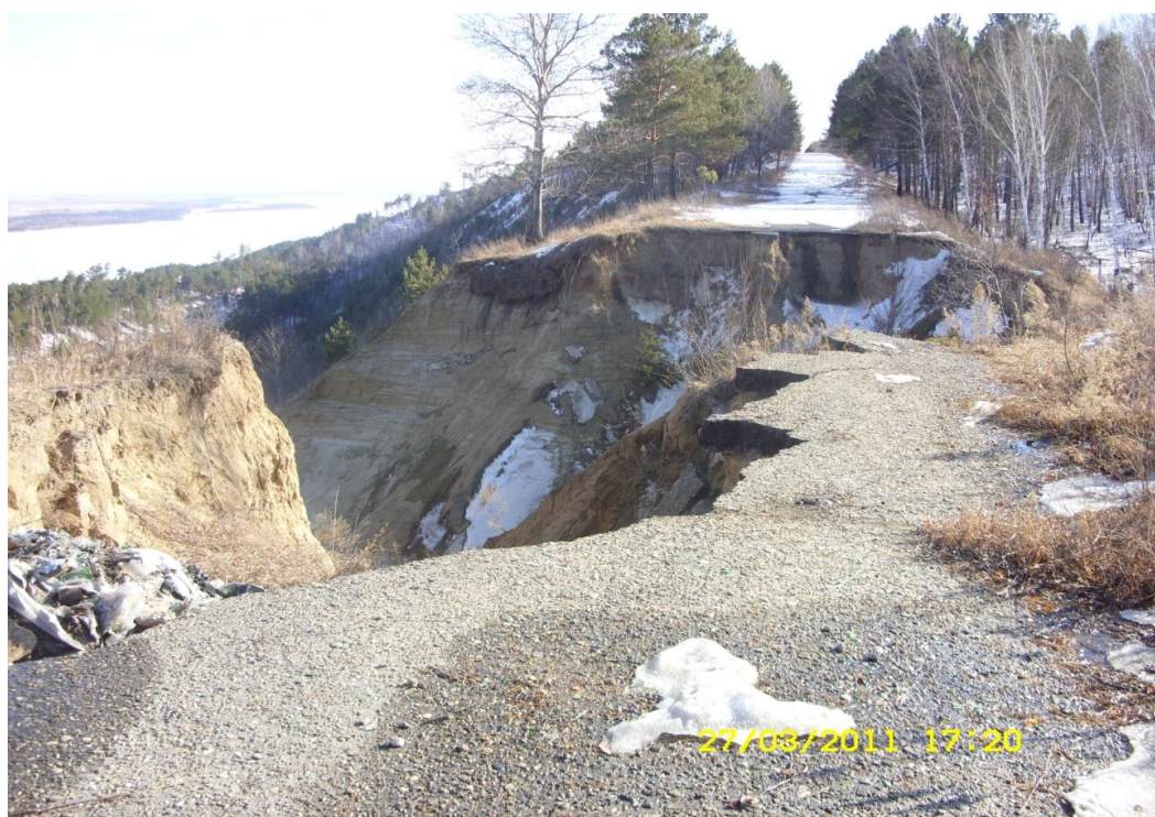
Рисунок 6 – Разрушенная дорога (Москвитинский оползень)
