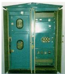
Подстанция комплектная трансформаторная тупиковая типа КТП-ТК
